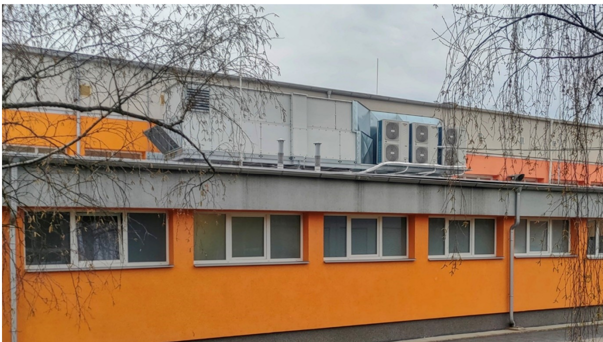
7 – Tělocvična je nově vybavena možností rekuperační výměny vzduchu.
