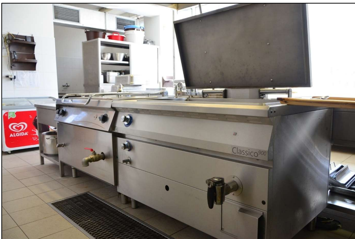
8 –Varný plynový kotel.
