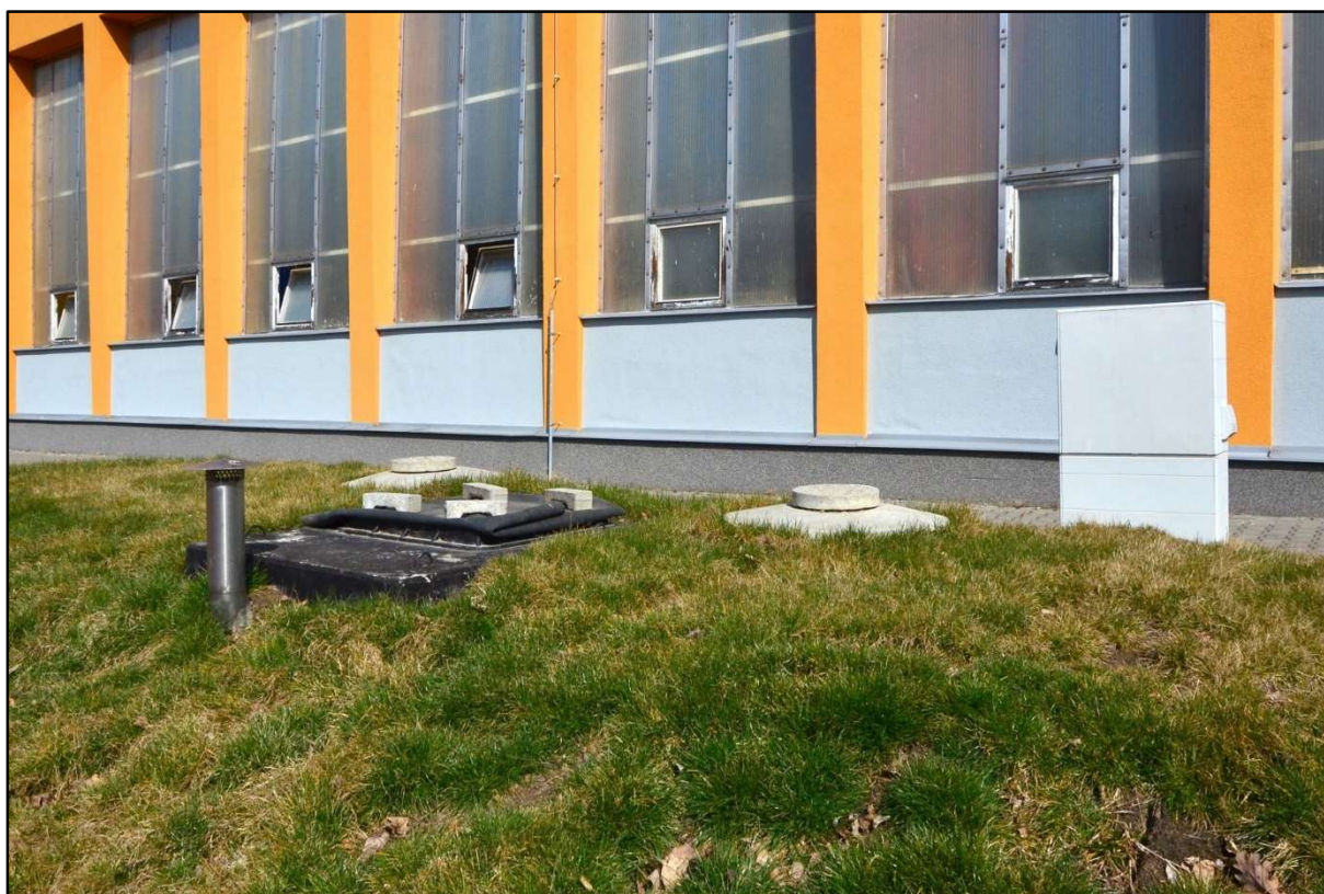
11 – Vrtaná studna se zásobníky.
