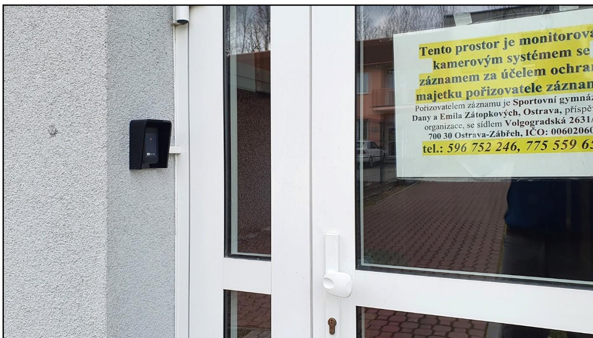
6 – Pro objekty tělocvičny a správního objektu sportovního areálu byl rozšířen bezkontaktní zabezpečovací přístupový systém.
