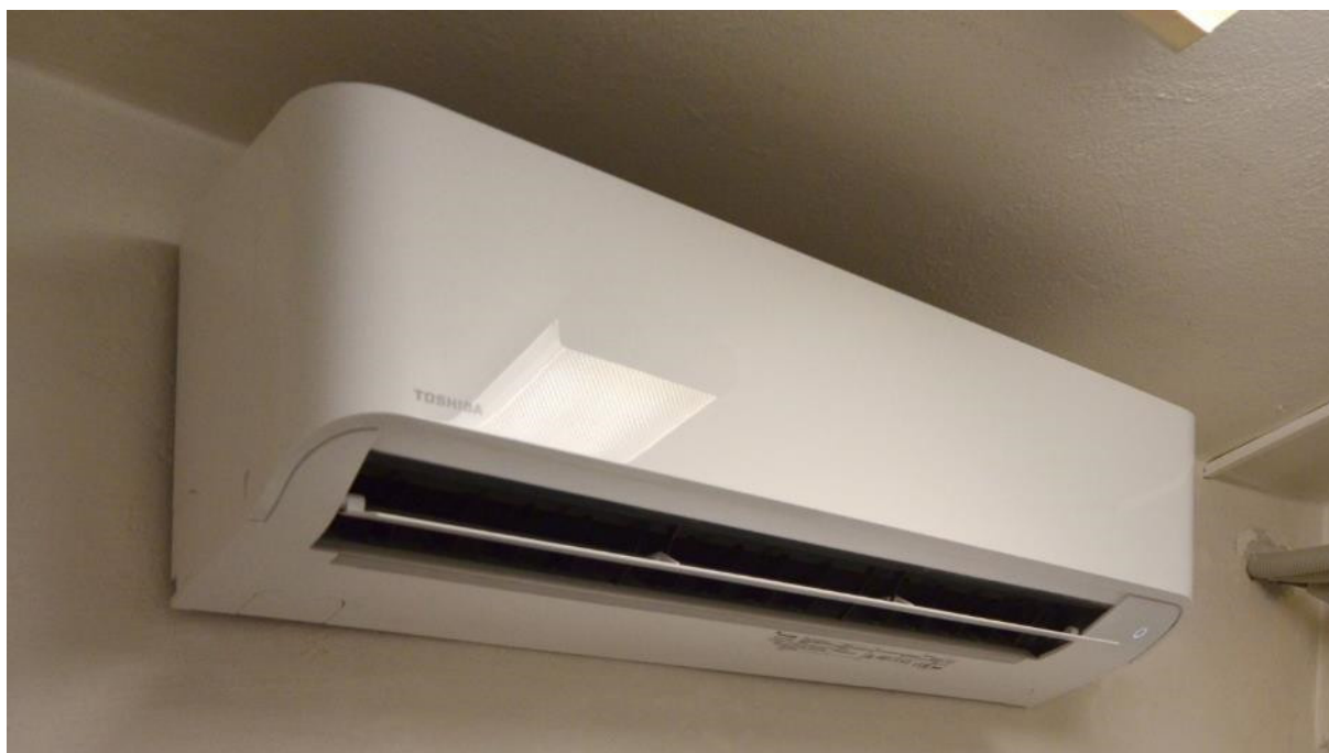
9 – Pro účinnější chlazení prostor ve skladu školní jídelny byla vybudována klimatizace
